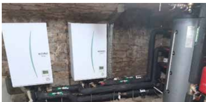
Les raccordements et équipements de chauffage.
