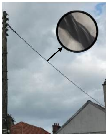
Réseau fils isolés aérien BT
