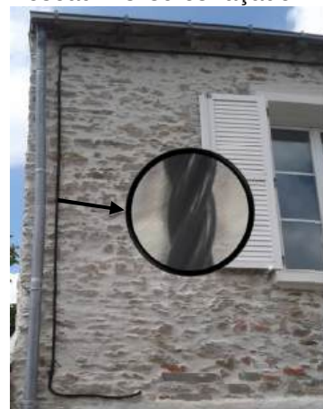
Réseau fils isolés façade BT
