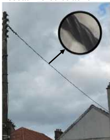
Réseau fils isolés aérien BT
