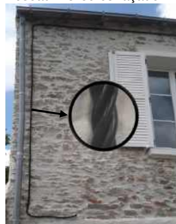
Réseau fils isolés façade BT
